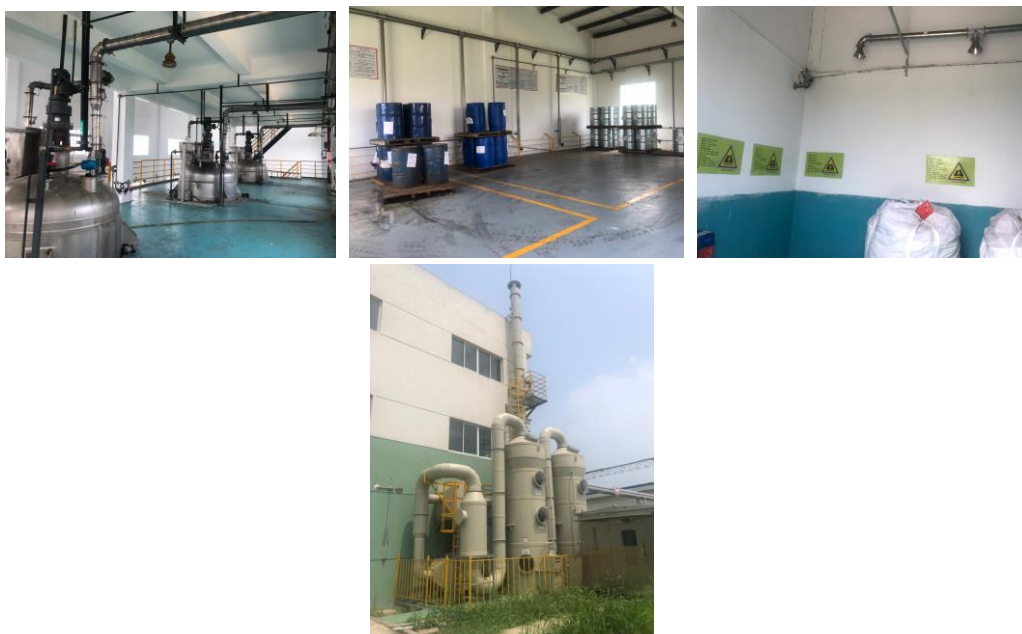
图 4.1-5 2#车间、危化品仓库、危废仓库废气收集、处理、排放图
