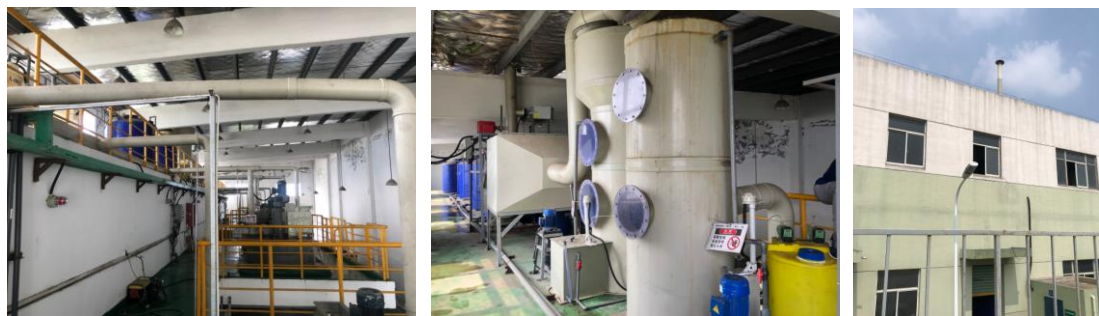
图 4.1-4 1#车间废气收集、处理、排放图
