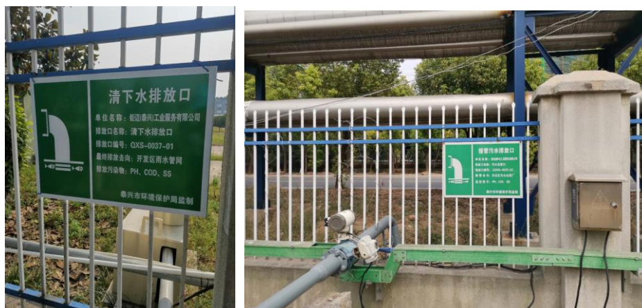
图 4.1-3 雨污水排口图
